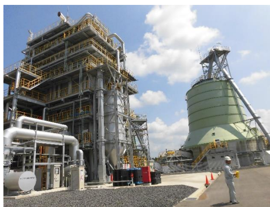
日立造船木質バイオマス発電所
